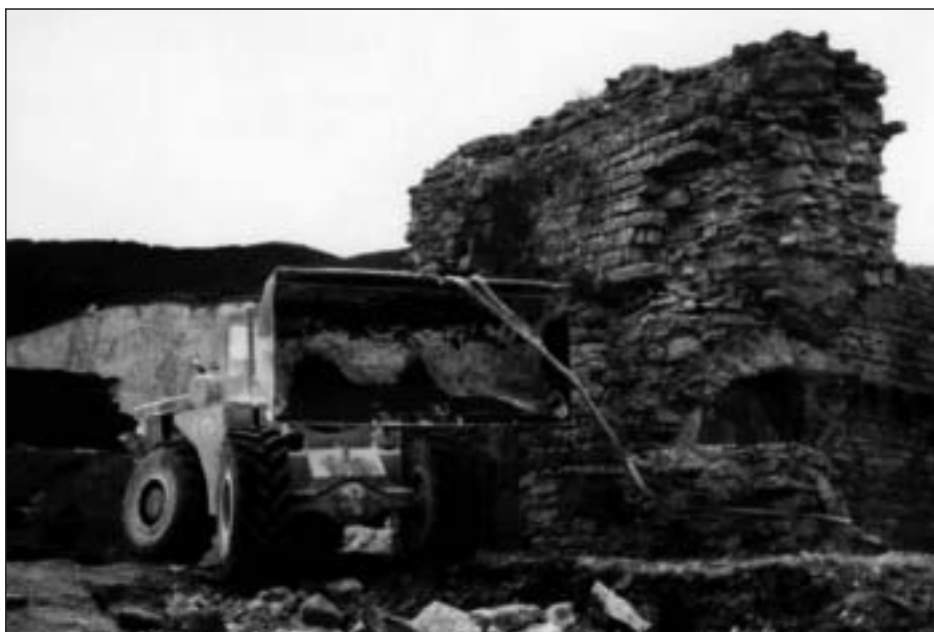
Foto 4. Retirando uno de los restos de los muros de la Sala de la Bodega con el auxilio de un bulldozer
