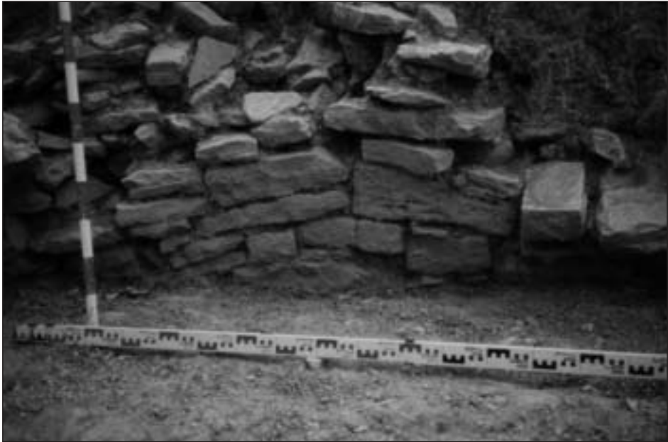
Foto 2. El muro perimetral en el Sector 1. Se aprecia su mal estado general así como el modo de construcción
