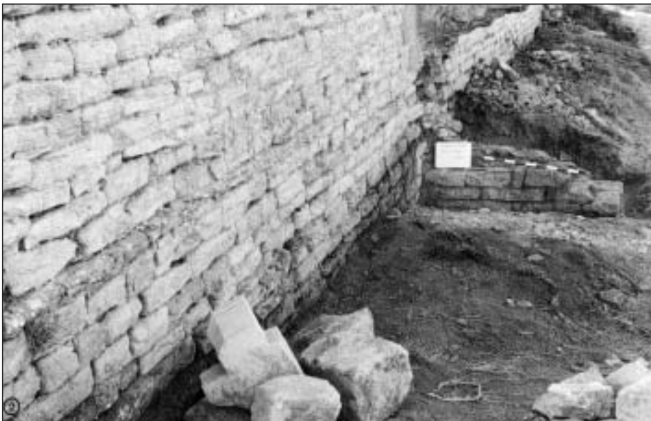
Lámina II: Muro 1, sector b. 1. Aspecto del contrafuerte en el que contrasta el estado de deterioro de la parte visible respecto de la enterrada. 2. Visión de conjunto del sector.
