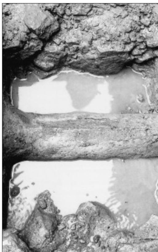
Tubería de plomo para salida del agua
